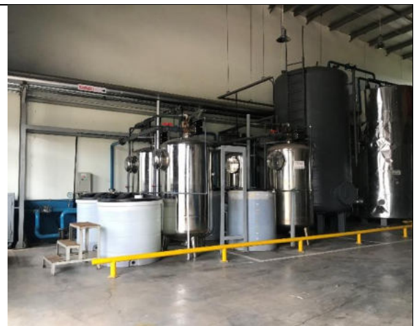
Khu vực xử lý nước cấp lò hơi và lưu trữ nhiên liệu dầu DO
