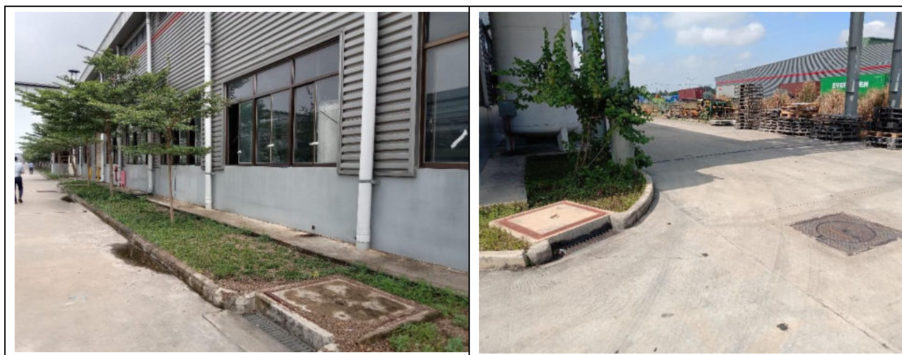
Hình 3. Hệ thống thu gom, tiêu thoát nước mưa tại Nhà máy Giang Điền - Công ty Cao su Kenda (Việt Nam)
